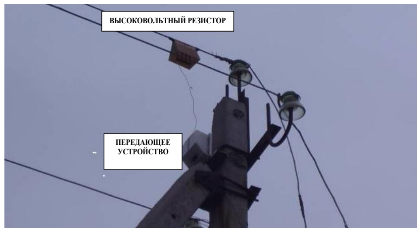
Рис. 2 – Передающее устройство, установленное на опоре высоковольтной линии
